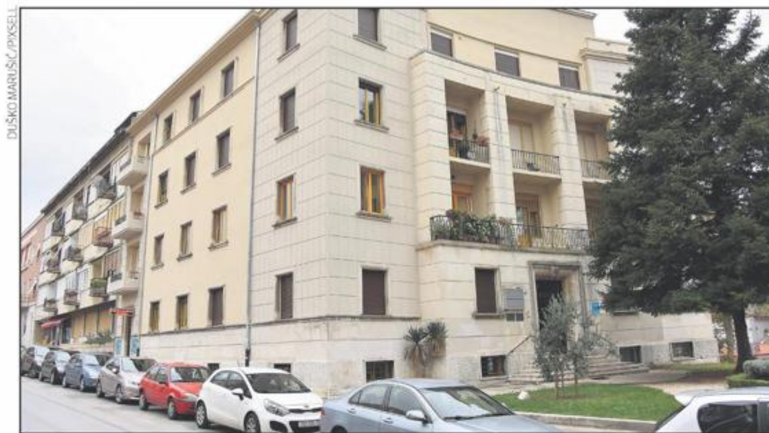
Iako je uređenje pročelja i krovovišta isključiva obveza vlasnika, u Gradu Puli itekako su svjesni važnosti uređenih, urednih i čistih pročelja zbog čega se intenzivno potiče njihova obnova projektom Dolcevita – rekao je gradonačelnik Boris Miletić
